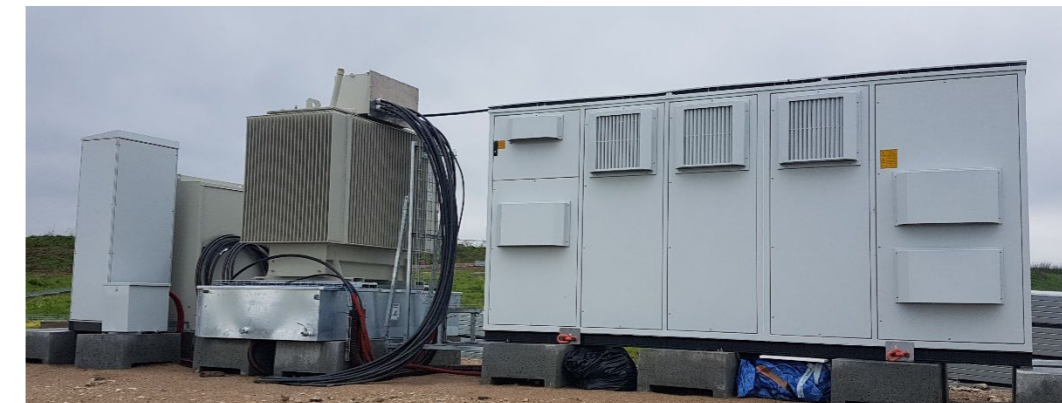
Exemple d'onduleurs et transformateur installés à l'extérieur
