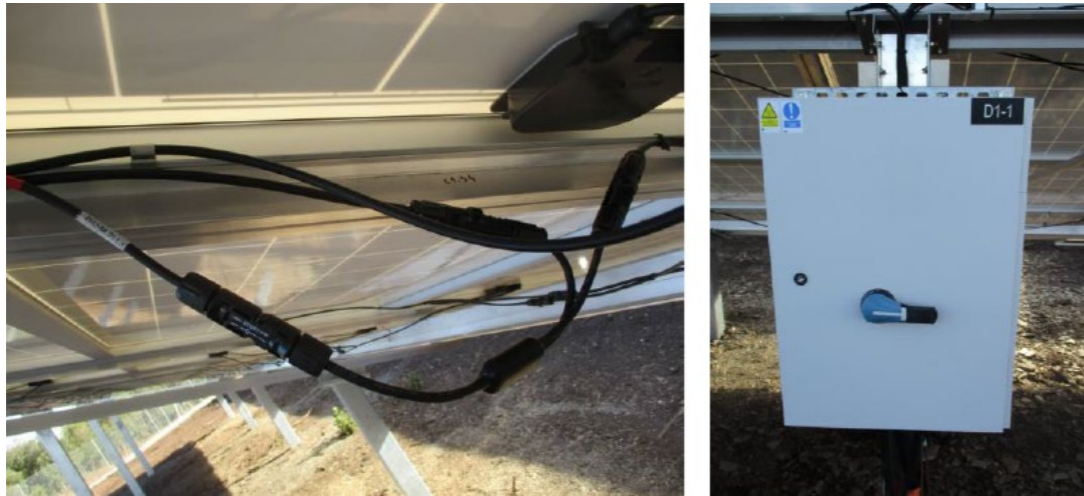
Figure 8 : Exemple de câble électrique et de boîte de raccordement (Source : RES)
